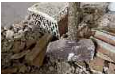
Mauerwerkbruch mit Potential © AiF e.V.
