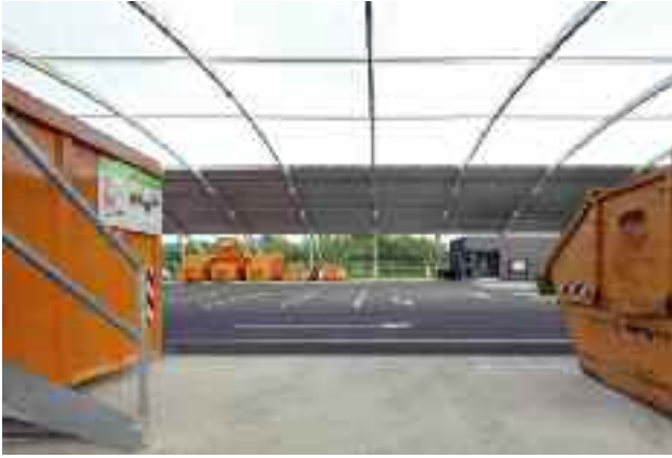
Überdachung der Containeraufstellfläche © Frank Aussieker
