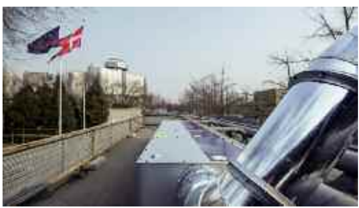
Anordnung des Climatic auf dem Gebäudedach © Infuser Deutschland GmbH
