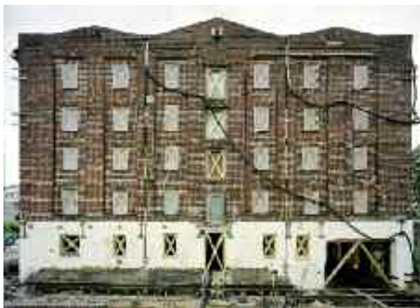
Zustand vor Instandsetzungsbeginn © Markus Dorf Müller und Johanna Klier
