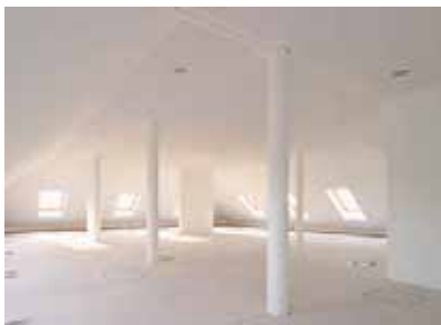
Akustikdesigndecken untern Dach © Knauf Gips KG/Albert
